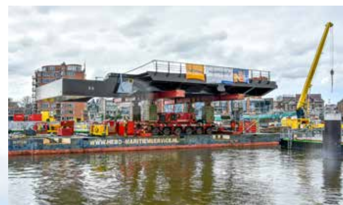
De Beatrixbrug staat gereed op hoogte om door de sluis te varen. Gezien de fasering kon deze pas later gemonteerd worden, maar moest wel eerst de toekomstige Wilhelminabrug passeren.
