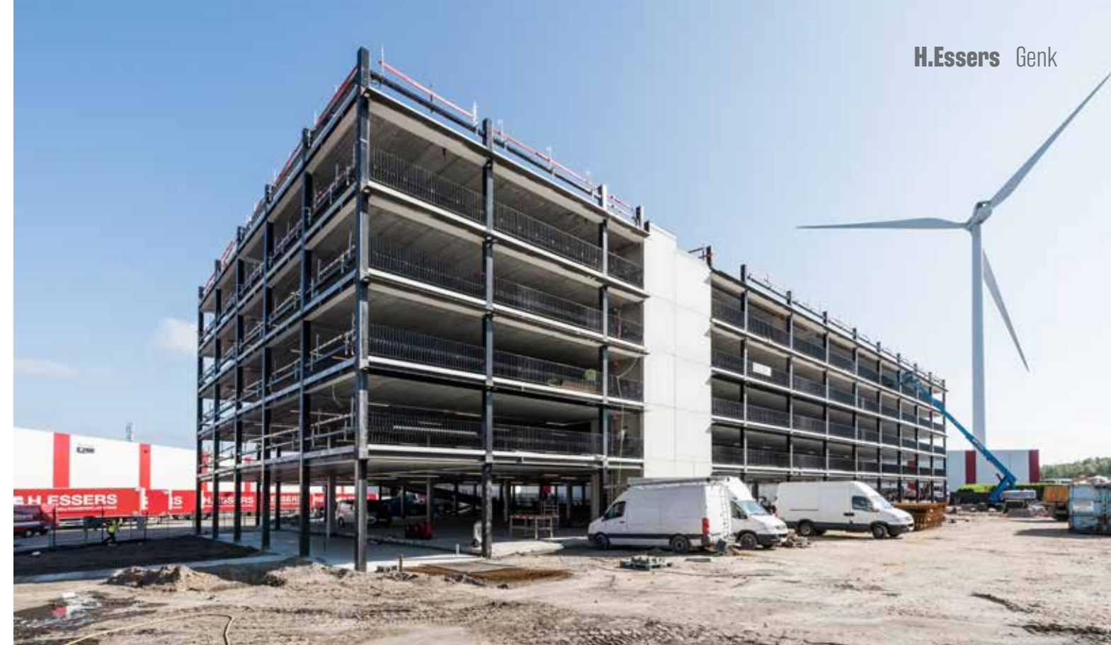
"Door de montage op te splitsen in drie fases konden we het parkeergebouw op amper zes maanden tijd finaliseren", zegt Jurgen Wolfs.
