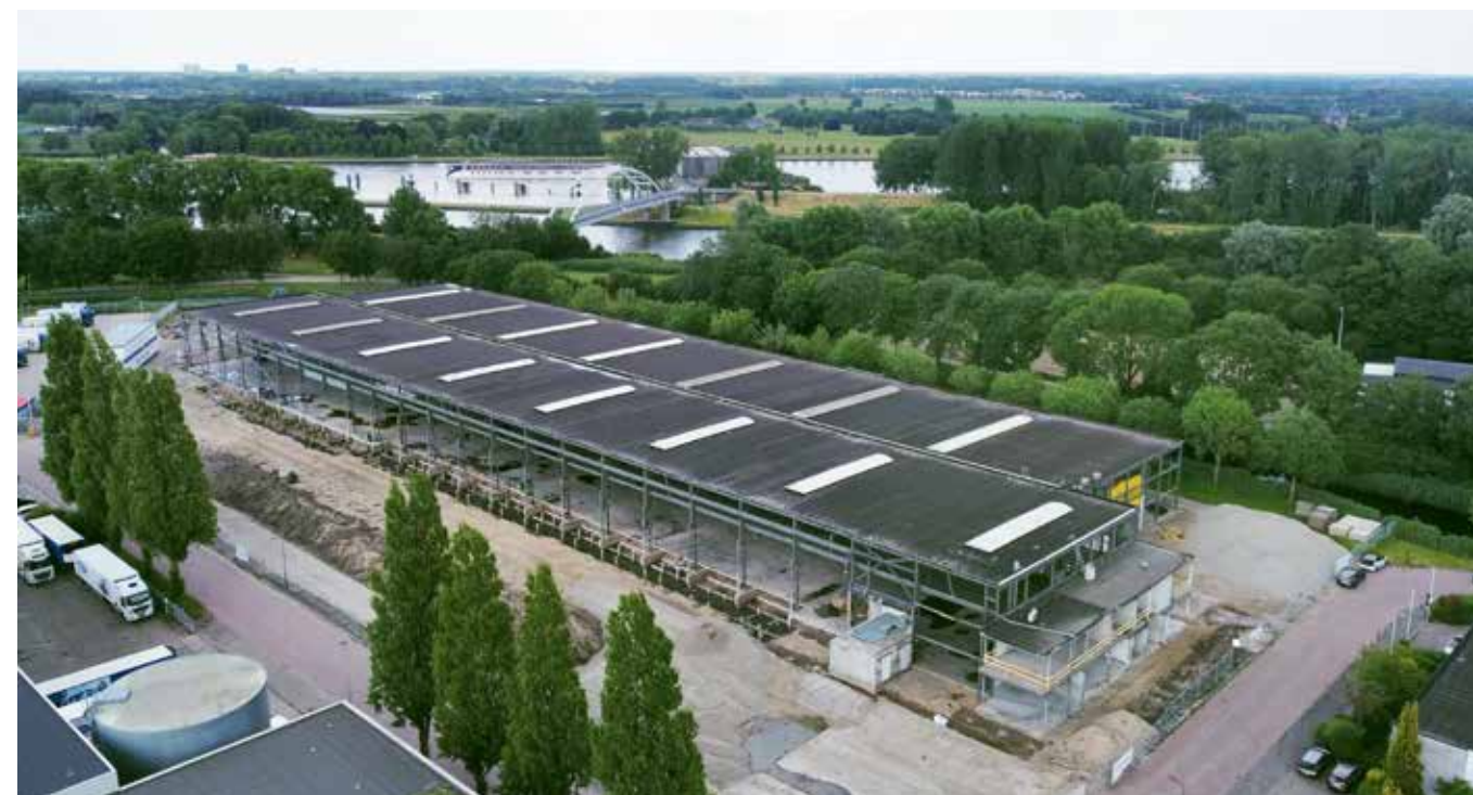
De bestaande heipalen zijn stuk voor stuk hergebruikt om de nieuwe laadkuil te ondersteunen.
